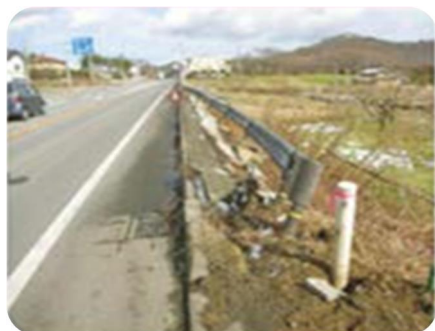
ガードレール・ 標識等の損傷
